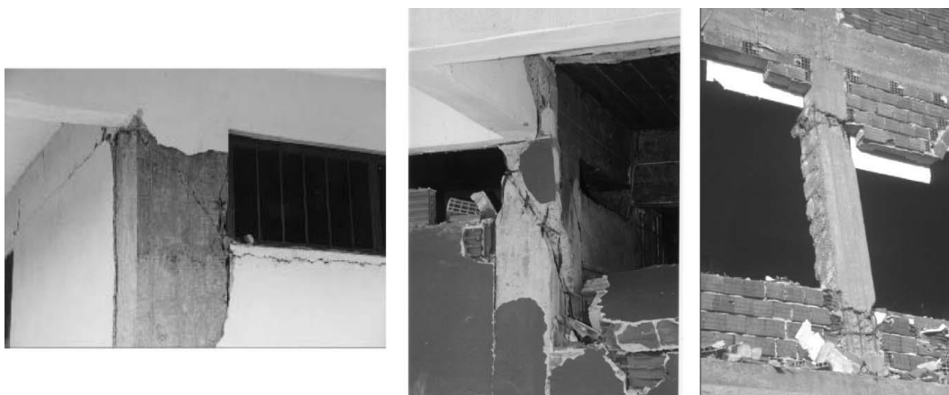
Figura 2.11 – Danneggiamento dei pilastri per effetto short-column (Varum, 2003).
