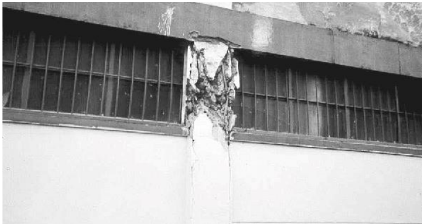
Figura 2.18 – Danneggiamento dei pilastri dovuto all'effetto short-column (Colombia, 1999 – Guevara & García, 2005).
