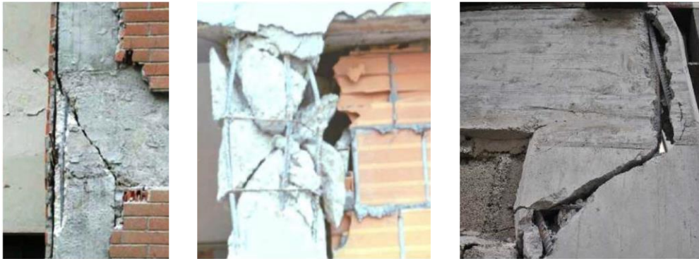
Figura 2.19 – Sgretolamento del calcestruzzo a causa della concentrazione di azioni taglianti (Cavaleri et al., 2017).
