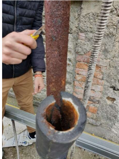
Figura 4.14 Tubazione del circuito primario
