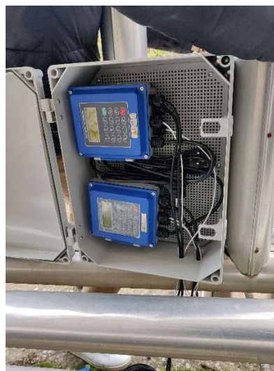
Figura 4.13 Armadio di protezione in policarbonato.
